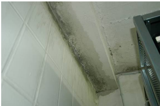
Abb. 4: Schimmelpilzbefall aufgrund einer Wärmebrücke im zentralen Außenmagazin des Bergbau-Archivs Bochum im Februar 2012
