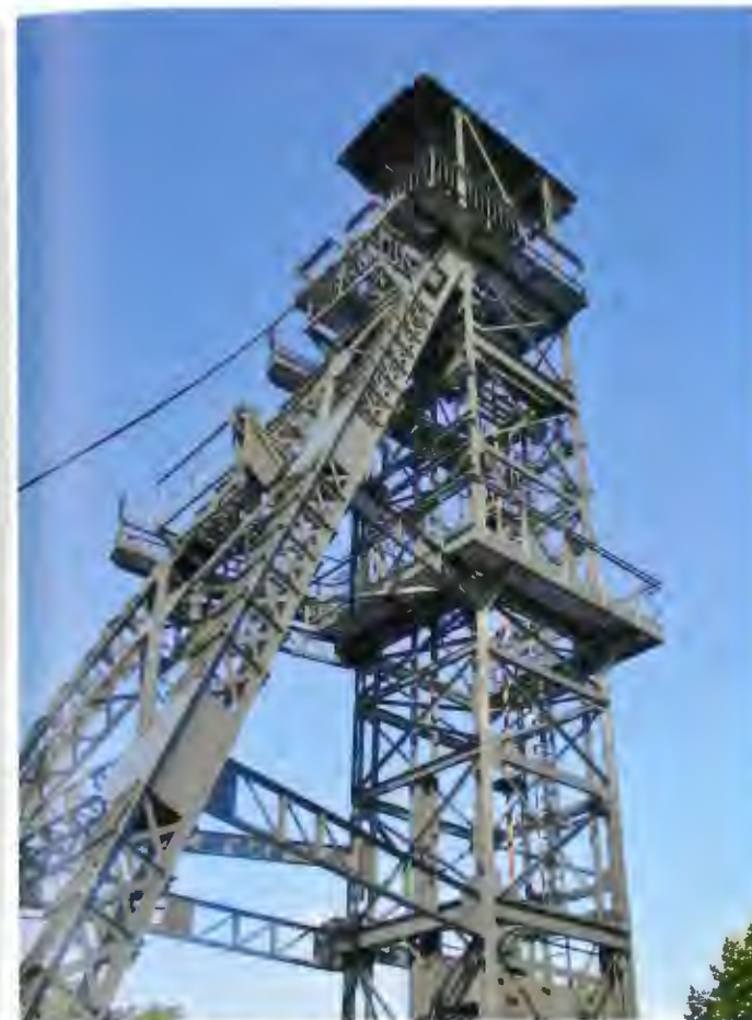
Abb. 6: Marles-les-Mines, Fördergerüst über dem Schacht Emil. 1906 / Fig. 6: Chevalement de la fosse Émile à Marles-les-Mines, 1906
