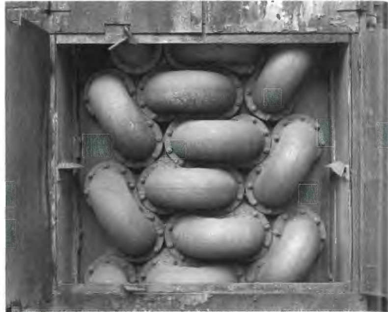
Abb. 11: Rohrkrümmer einer Kühleinrichtung an der Benzolanlage, Kokerei Hansa, Dortmund 2003, 135 cm x 116 cm
