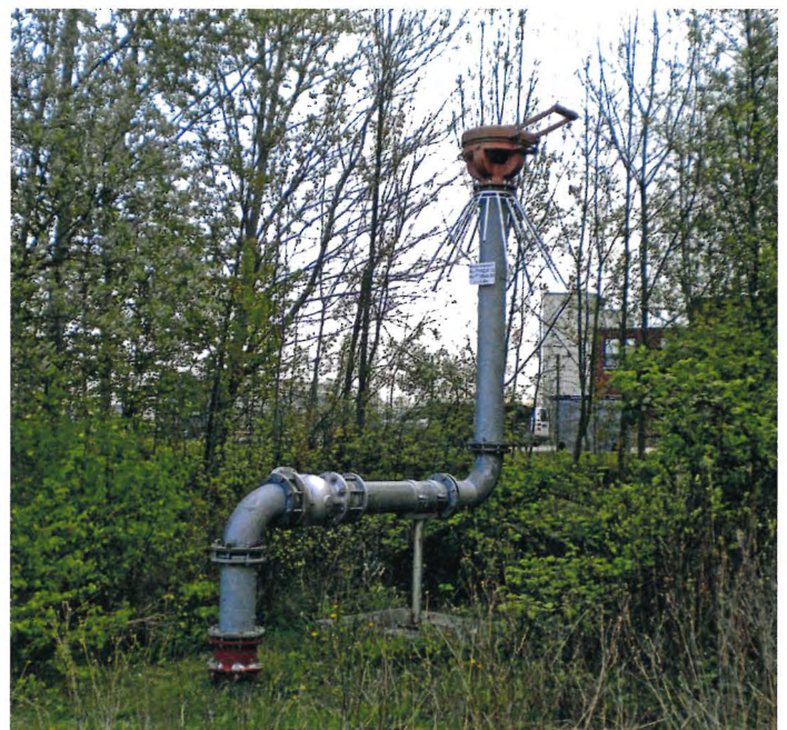
Abb. 14: Protegohaube auf Schacht 1
