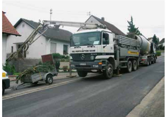
Abb. 8: Durch einen massiven Verbruch entstand ein Hohlraum oberhalb des Stollens, der mit 19 m 3 Beton aufgefüllt wurde. (© Foto: S. Müller, DBM)
