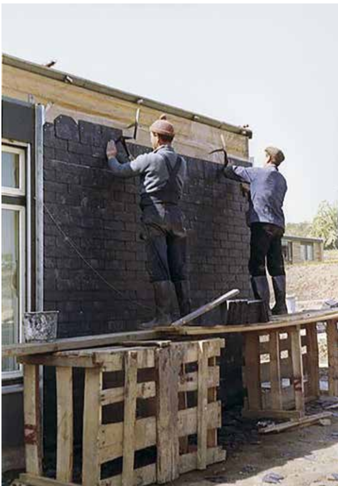
Abb. 13: Krupp-Fertighäuser in der Professorensiedlung in Bochum, Bearbeitung Außenwände o. J. (Universitätsarchiv Bochum, Dep. Staatl. Bauamt Bochum 02, FA-Nr. 69, Az 0/122/7520, Sofortprogramm, 66.0442 (© Bau- und Liegenschaftsbetrieb NRW))
