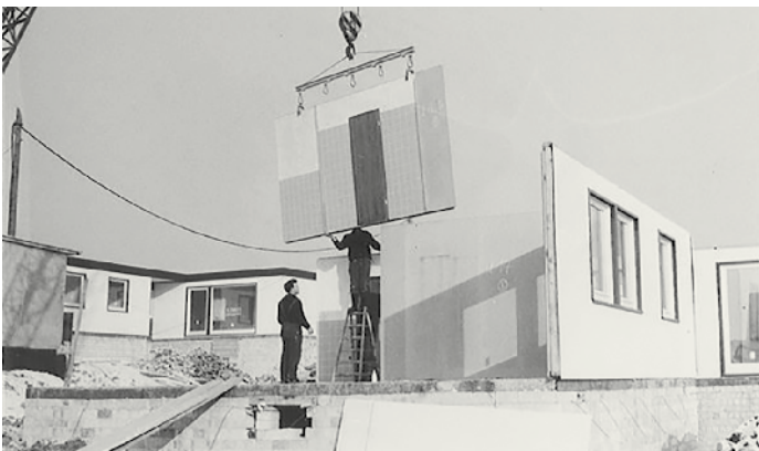
Abb. 9: Zenker-Fertighaus in der Professorensiedlung in Bochum im Bau o. J. (Universitätsarchiv Bochum, Dep. Staatl. Bauamt Bochum 02, FA-Nr. 69, Az 0/122/7520, Sofortprogramm, 66.0074 (© Bau- und Liegenschaftsbetrieb NRW))
