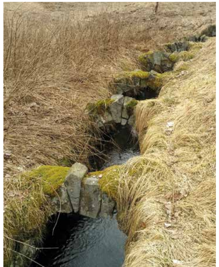
Abb. 6: Steinbögen am Zellerfelder Graben zur Auflage einer Grabenabdeckung im Winter. (© Foto: K. Malek, NLD)
