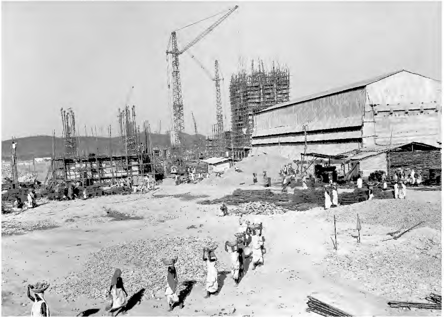
Abb. 10: Kokerei Rourkela, Indien, o. D. Zu sehen sind die von einer Halle geschützte Batterie II sowie dahinter ein mit Bambus eingerüsteter Kohlenturm. Der Transport von Material erfolgte zum Teil auf traditionelle Weise. (© Foto: thyssenkrupp Corporate Archives, Duisburg (FG/2339))
