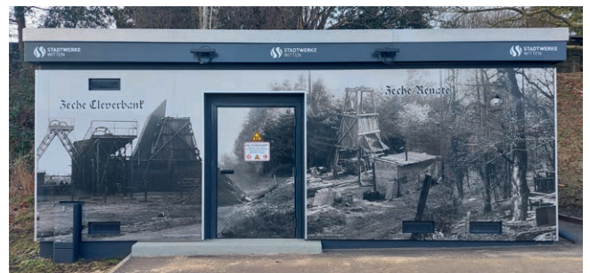
Gasdruckregelanlage Vormholz mit Fotografien aus dem montan.dok (Foto: Dr. Michael Farrenkopf)
